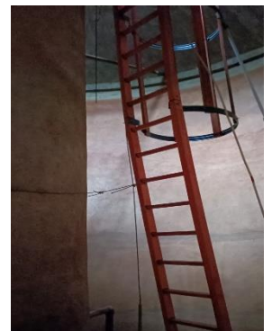
Échelle du château d'eau de Luzillé à renouveler
